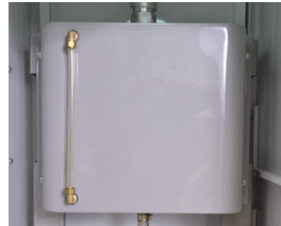
ถังเก็บน้ำมัน
